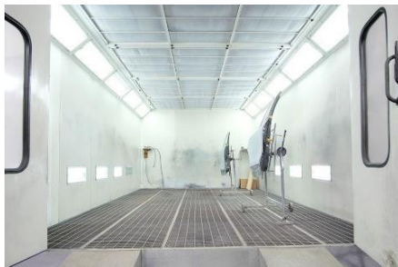
Cabine d'aspiration fermée et ventilée
